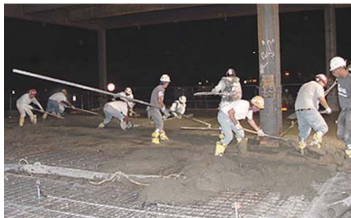
Figura 1.18: Hormigón poco trabajable.
