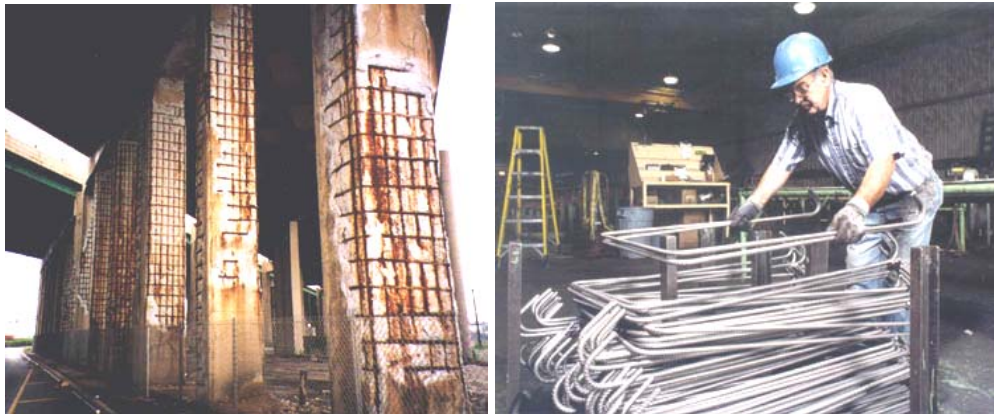
Figura 3.16: Acero de refuerzo con corrosión (izquierda) y sin corrosión (derecha).
