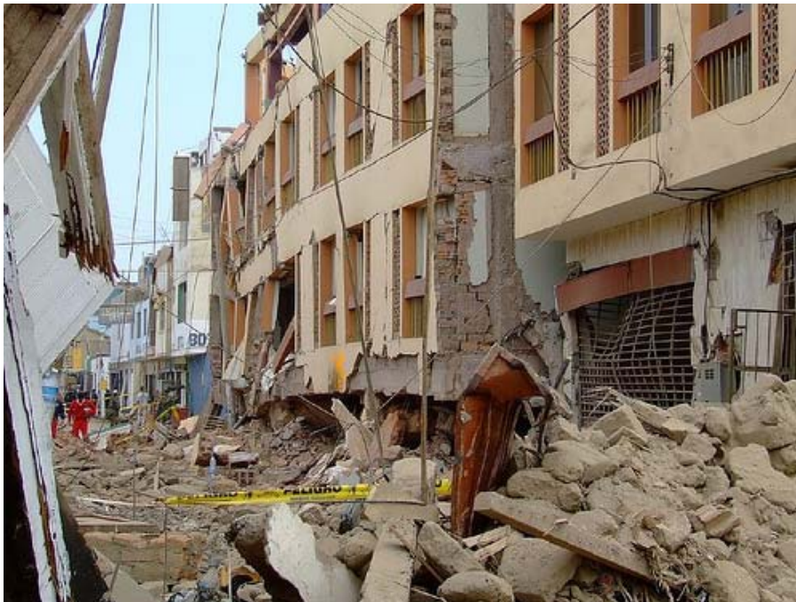
Figura 15.3: Edificios afectados por la acción sísmica.
